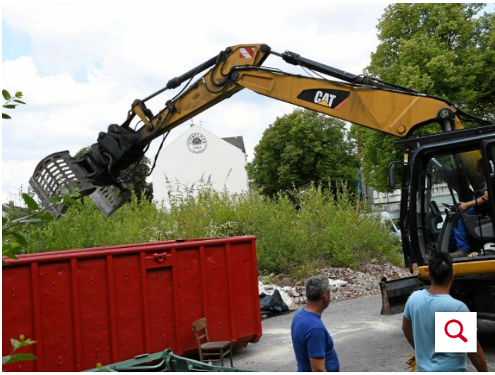
Am Dienstag wurde das alte Trafohäuschen auf dem Gelände der Brauerei Schwelm abgerissen. Foto: Bernd Richter / WP
