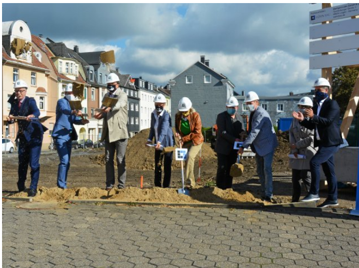
Symbolischer Spatenstich für das Kulturzentrum an der Römerstraße in Schwelm. Am Montag fand die Grundsteinlegung statt. Foto: Max Kölsch / WP
