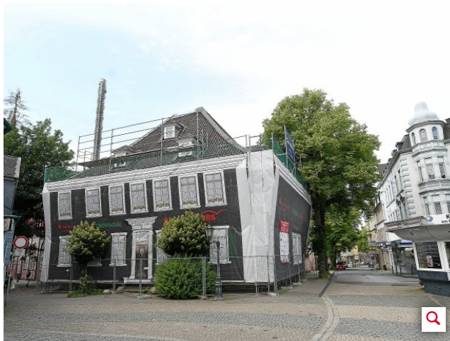
Die Sparkasse Schwelm muss Patrizierhaus abreißen. Es soll in ähnlicher Form neu gebaut werden. Foto: Bernd Richter / WP
